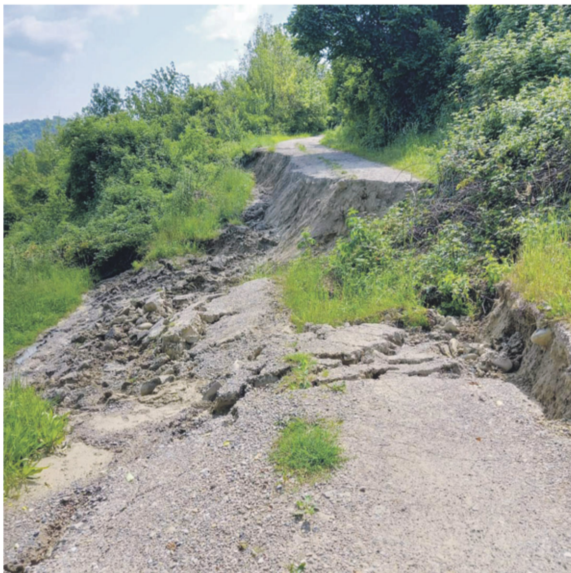
Sopra, una frana provocata dal maltempo di maggio nella zona di Purocielo, frazione di Brisighella
